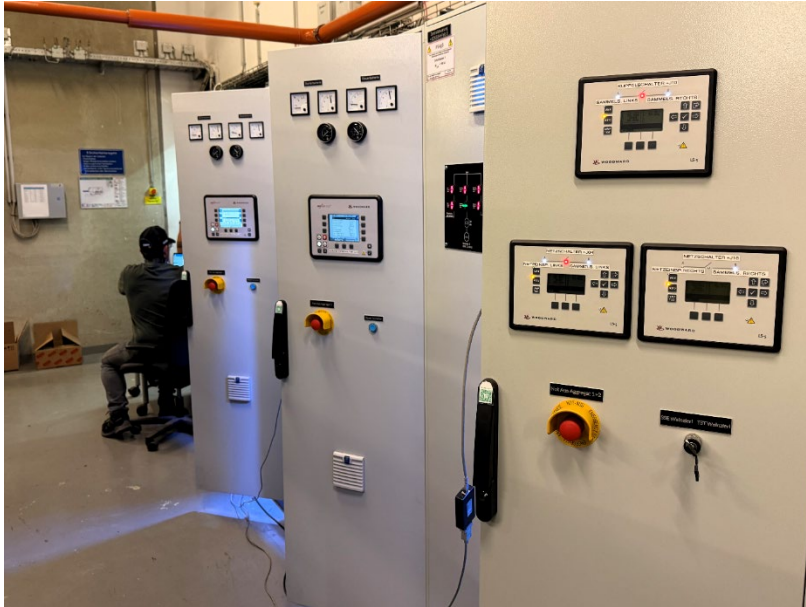
Bild 2: Vorbereitungen für den Stromresilienz-Test werden getroffen
